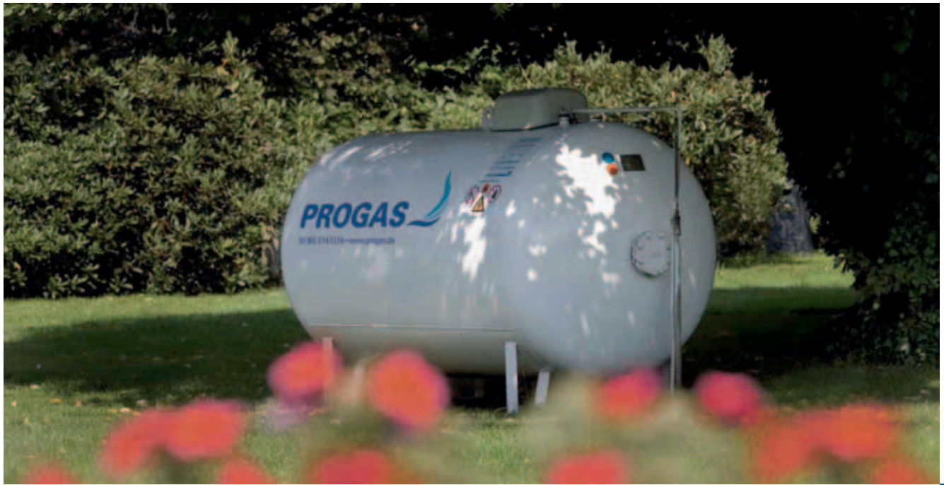
Flüssiggas-Lagerbehälter von PROGAS
